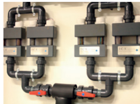
ICA-systemet overvåker og behandler kontinuerlig både varmt- og kaldtvannet ved Lovisenberg Diakonale Sykehus. Foto Knut E. Braaten
